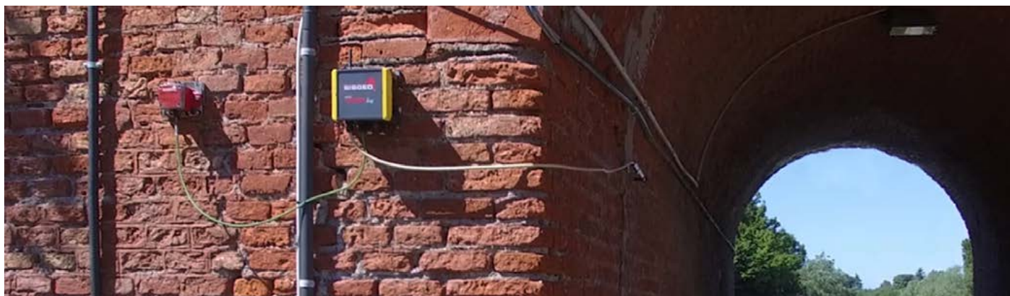
Clinómetro instalado en un contrafuerte de puente, Cassano d'Adda - Italia
