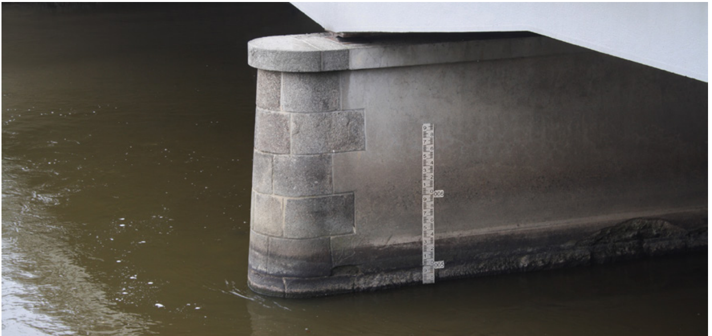
Astas hidrométricas instaladas sobre el pilar de un puente
